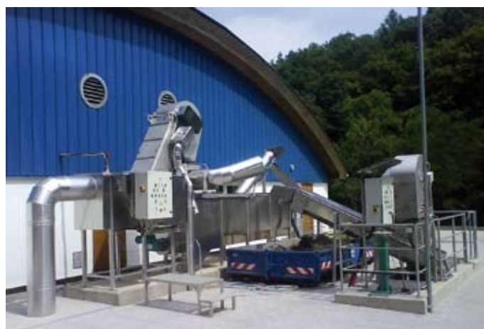
Systém hrubého předčištění ČOV Úvaly
