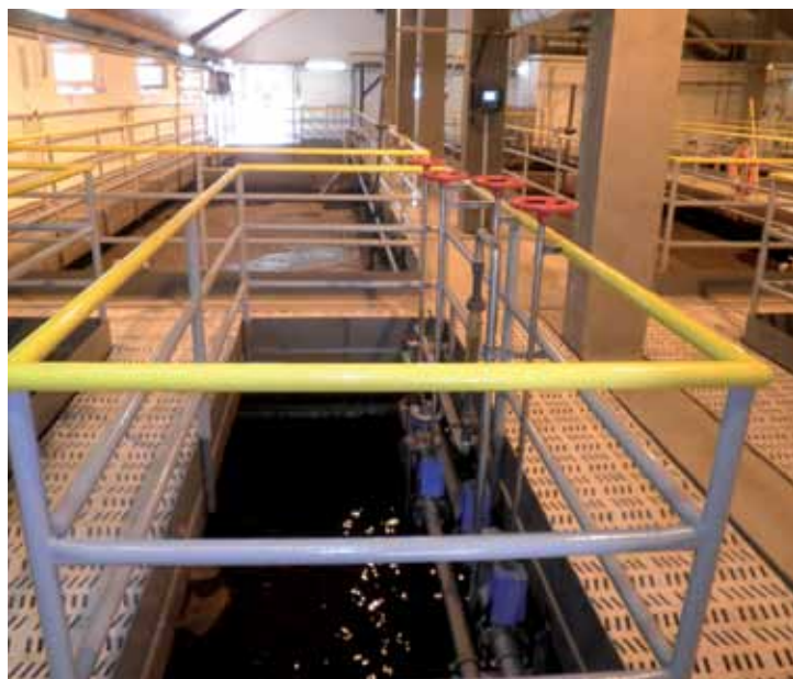
Čistírna odpadních vod Úvaly
