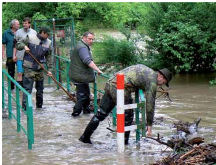
Odstraňování naplaveného dřeva pod školou
